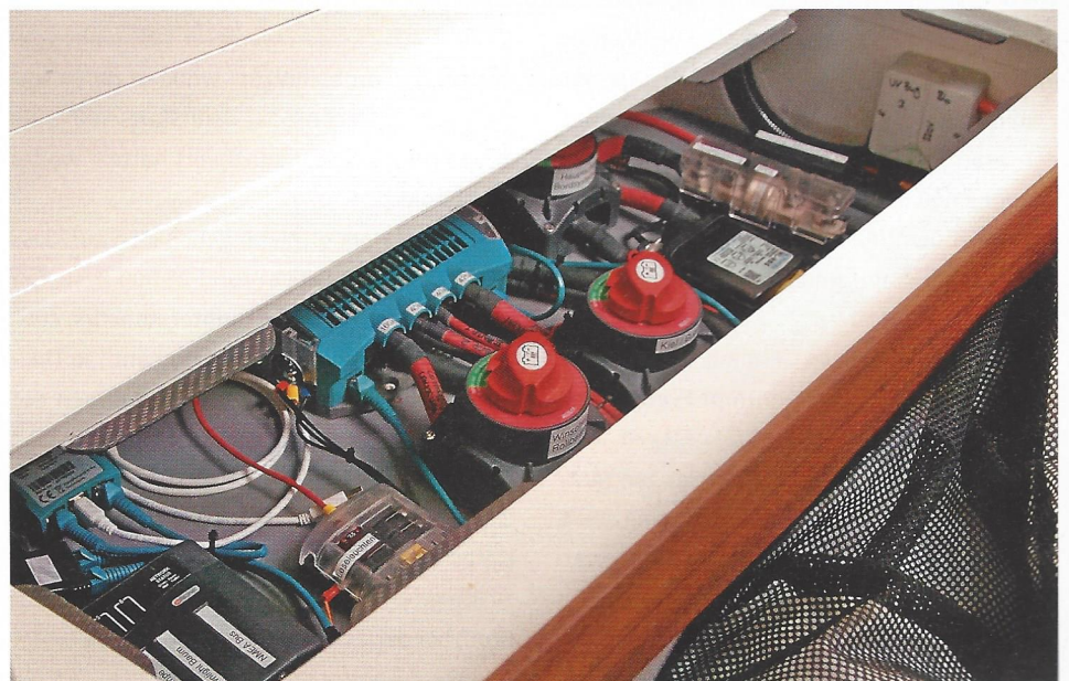
Das Boot enthält aufwendige Lade- und Regeltechnik für die verschiedenen Batteriebanken.
